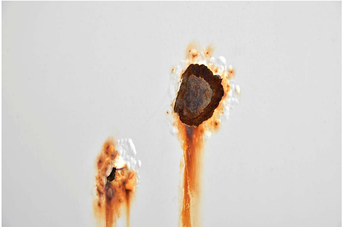
Mynd 3. Byrðingur geymis er tvöfaldur og er ytrabyrði hans málað. Á stöku stað má sjá tæringarbletti líkt og má sjá hér.
